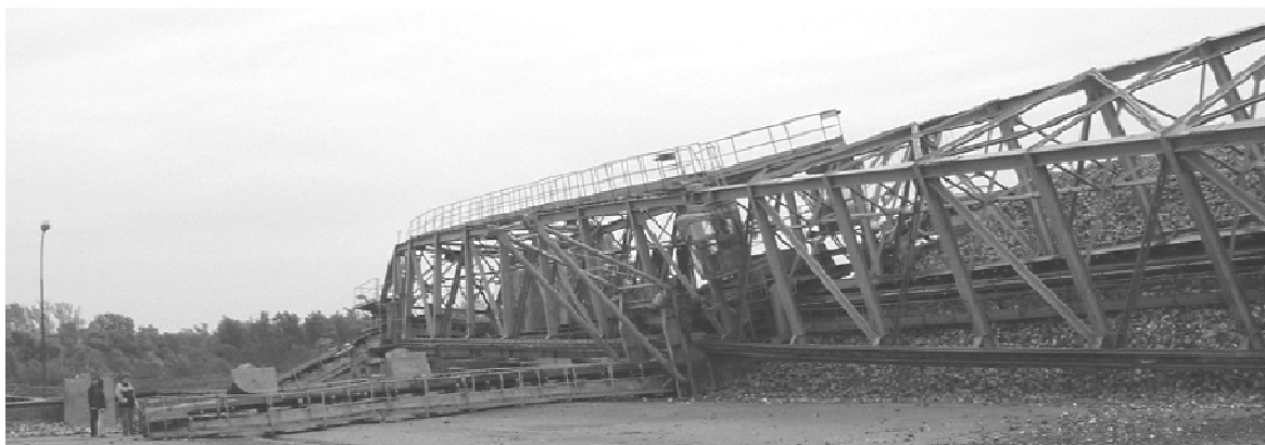
Sl. 1.25 Kolaps noseće konstrukcije pretovarnog mosta u Senti, [184]
