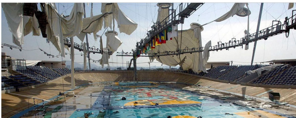
11 – Membranska konstrukcija uništena dejstvom vetra ( www.gettyimages.com )
