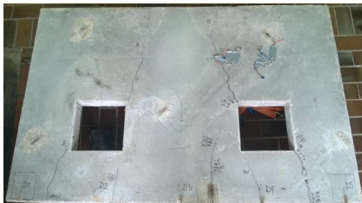
Slika 4.99 - Konačna slika prslina uzorka Z3 - zadnja strana površine zida
