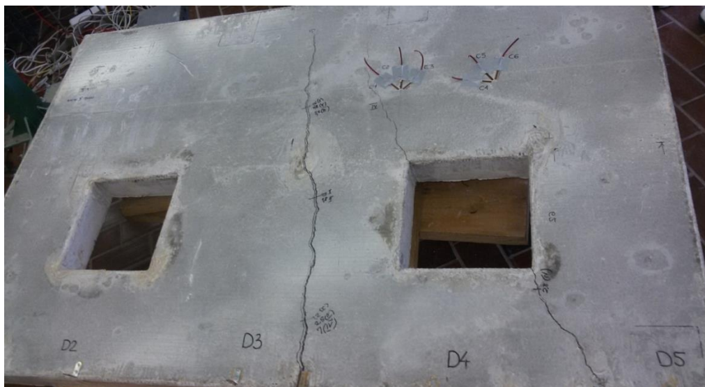
Slika 4.85 - Konačna slika prslina uzorka Z2 - zadnja strana površine zida
