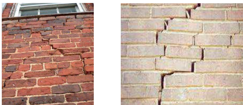
Slika 5.14 Pojava dijagonalnih pukotina u zidovima
