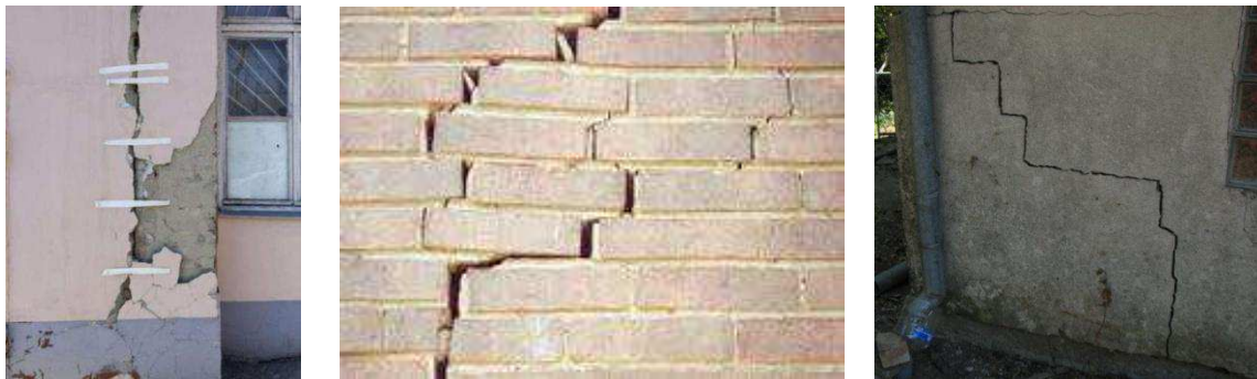
Slika 3.3 Pojava prslina i pukotina na fasadama
