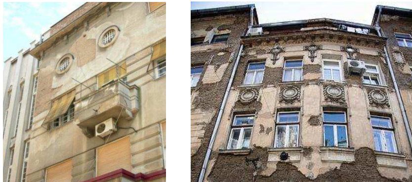
Slika 3.5 Oštećenja fasada objekata
