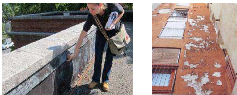
Slika 4.1 Vizuelni pregled objekta
