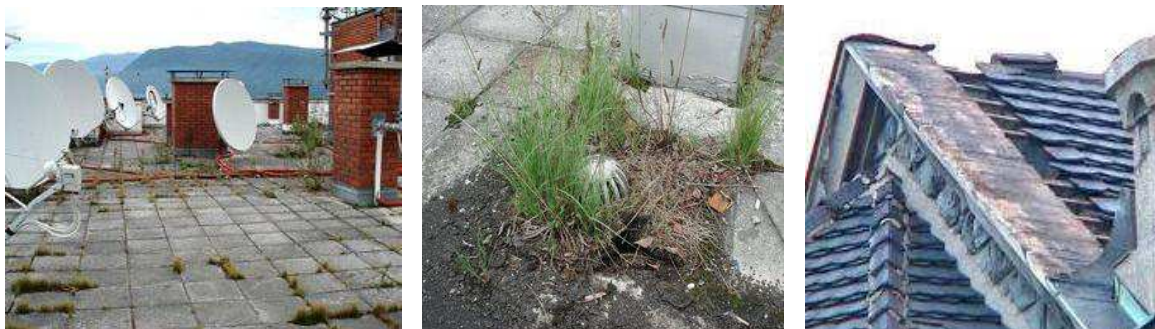
Slika 5.54 Oštećenja na ravnim i kosim krovovima
