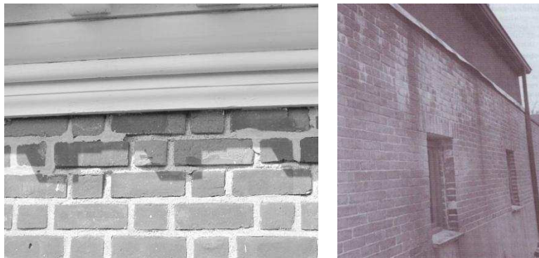
Slika 3.6 Loše izvedeni detalji odvodnjavanja sa objekata [Newman, 2001]
