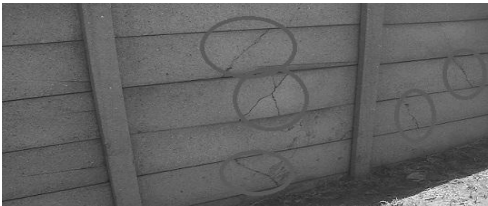
Слика 68. Деградиција бетона услед утцаја инцидентног оптерећења 42
