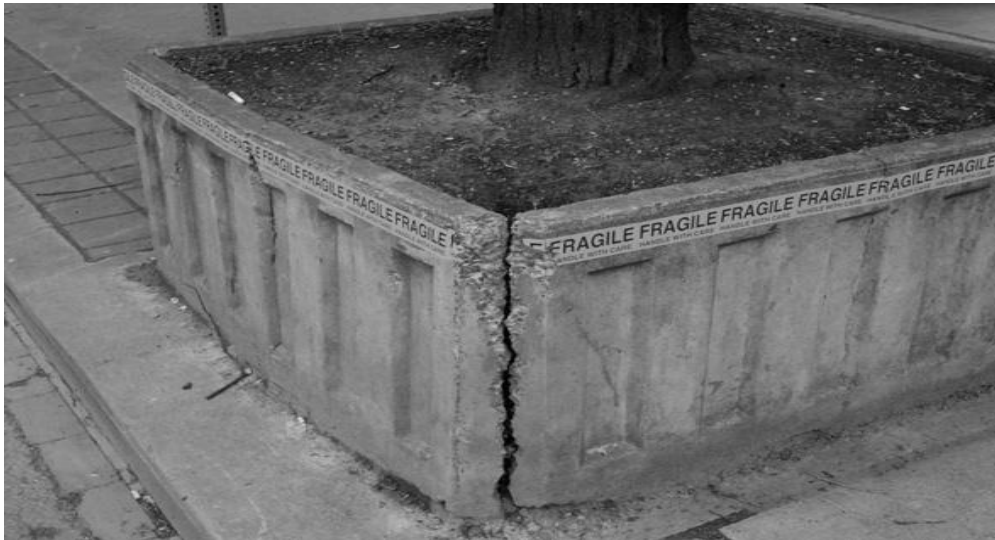
Слика 66. Деградиција бетона услед неадекватног армирања 40
