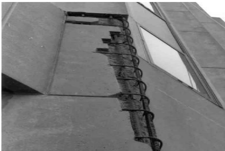
Слика 62. Фасадни елементи деградирани корозијом 38
