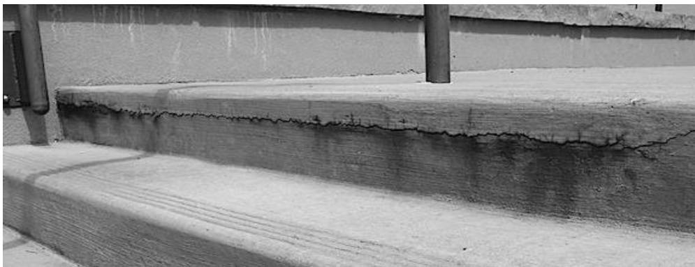
Слика 67. Деградиција бетона услед утцаја корозије 41
