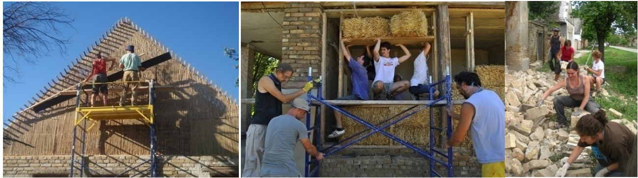
Sl. 78,79,80 Participativno gradilište - Radionice u organizaciji Centra za zemljenu arhitekturu na rekonstrukciji kuće u Mošorinu u periodu 2012-2016.
