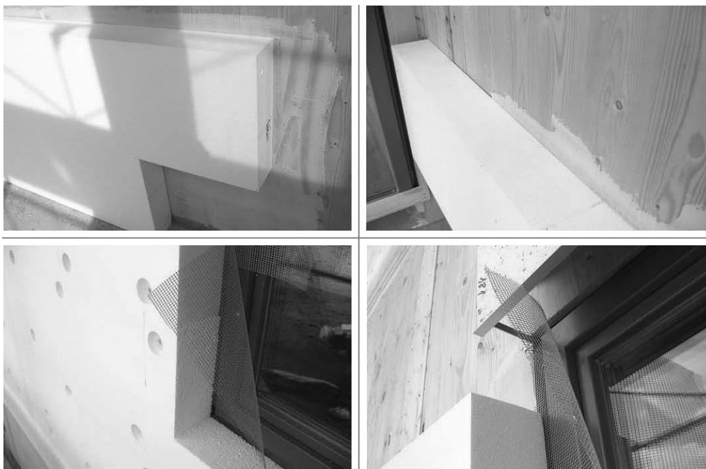
Слика 29. Детаљи извођења фасадног зида са топлотном изолацијом од експандираног полистирена (EPS) [100]
