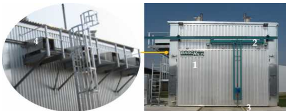
Слика 14 . Фронтална страна коморе (1-врата, 2-систем за отварање врата, 3-шине за транспорт материјала, 4-електромотори за покретање вентилатора) (Дамјанац, 2010)
