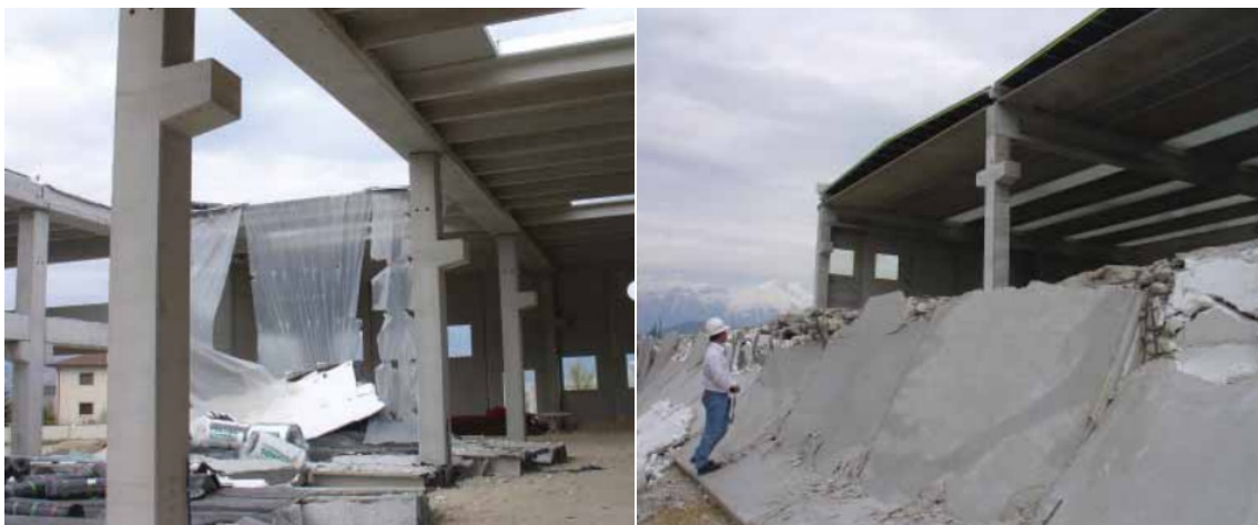
Sl. 8.5d Karakterističan primer oštećenja za vreme zemljotresa u Italiji: Detalji oštećenja i rušenja veza i objekata.
