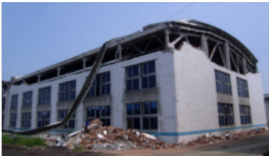
Sl. 8.3a Karakterističan primer oštećenja za vreme zemljotresa u Kini: Oštećenja veza i objekta u celini.
