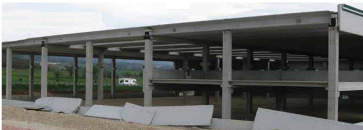
sl. 8.5c Karakterističan primer oštećenja za vreme zemljotresa u Italiji: Detalj oštećenja i parcijalnog rušenja objekta.
