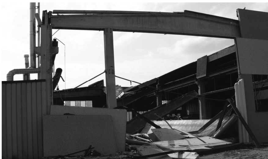
sl. 8.5a Karakterističan primer oštećenja za vreme zemljotresa u Italiji: Detalji totalno srušenih objekata.
