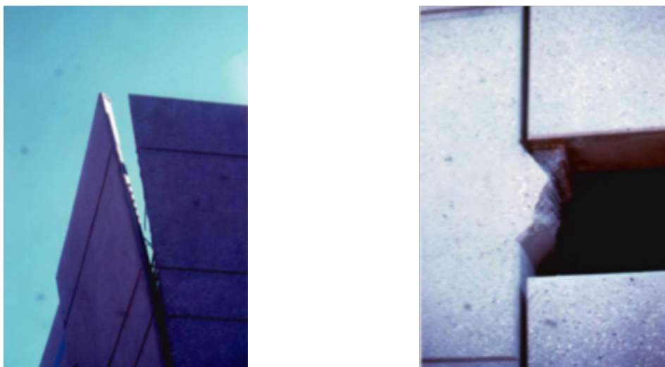
Sl. 8.1 Karakterističan primer oštećenja hala za vreme zemljotresa u Americi: Dislokacija celog panela (a) i oštećenja veza (b).
