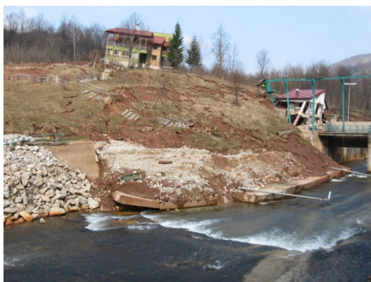
Slika 4.6. MHE Bogatići na području Trnova gdje je klizište u 2011. godini oštetilo hidroelektranu
