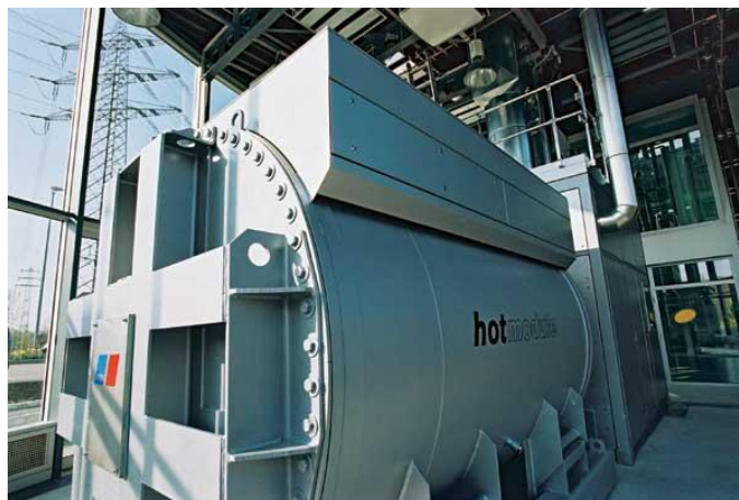
Slika 12. MTU CFC HotModuel instalaciju u Essenu.
