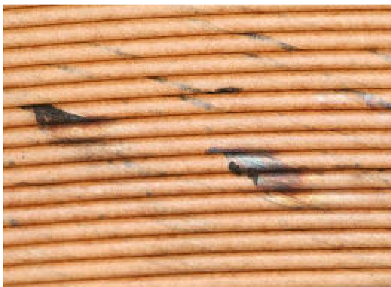
Slika 1.2.2.1. Depoziti bakar sulfida u namotajima havarisanog transformatora [22]
