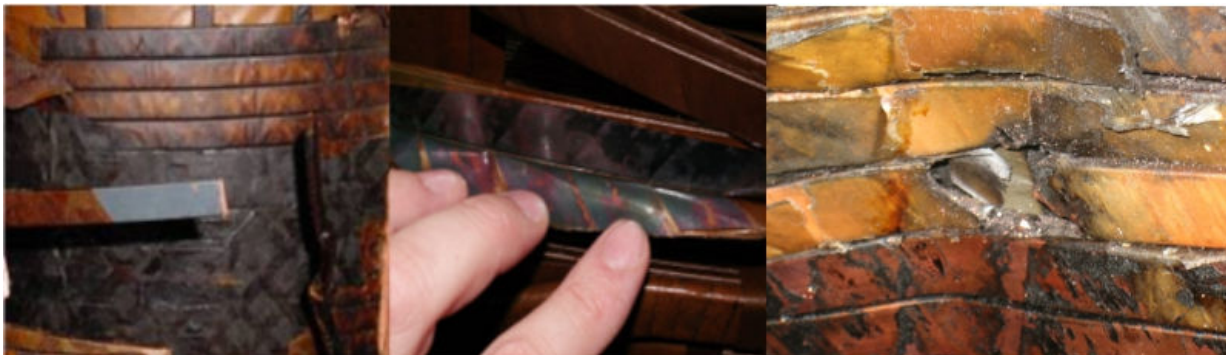
Slika 1.2.2. Izgled havarisanog namotaja, levo - bakarni provodnik i namotaj, desno – unutrašnji sloj papira sa puno \text{Cu}_2\text{S} depozita [22]
