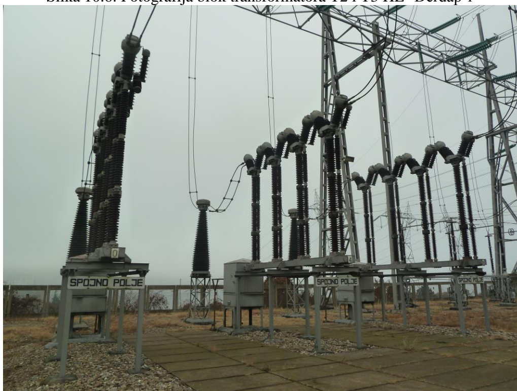
Slika 10.7: Fotografija prekidača u spojnom polju 400 kV postrojenja HE "Đerdap 1"
