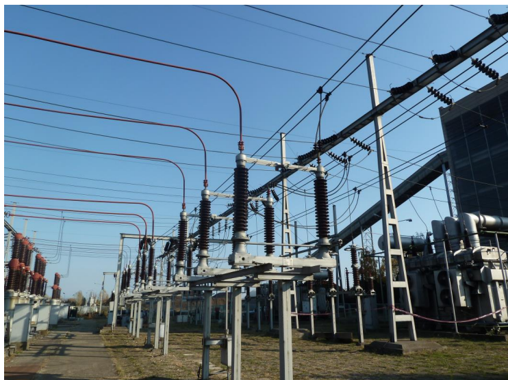
Slika 7.25: Prikaz dela 110 kV postrojenja TE "Morava"
