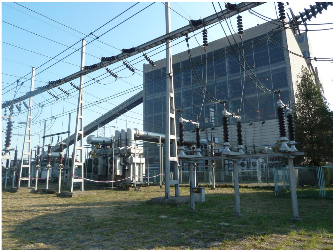
Slika 10.17: Fotografija dela postrojenja 110 kV TE "Morava"
