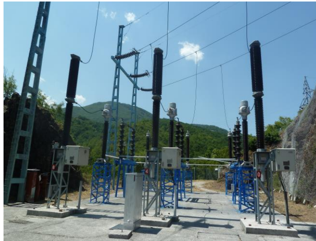
Slika 7.39: 220 kV postrojenje HE "Bistrica"
