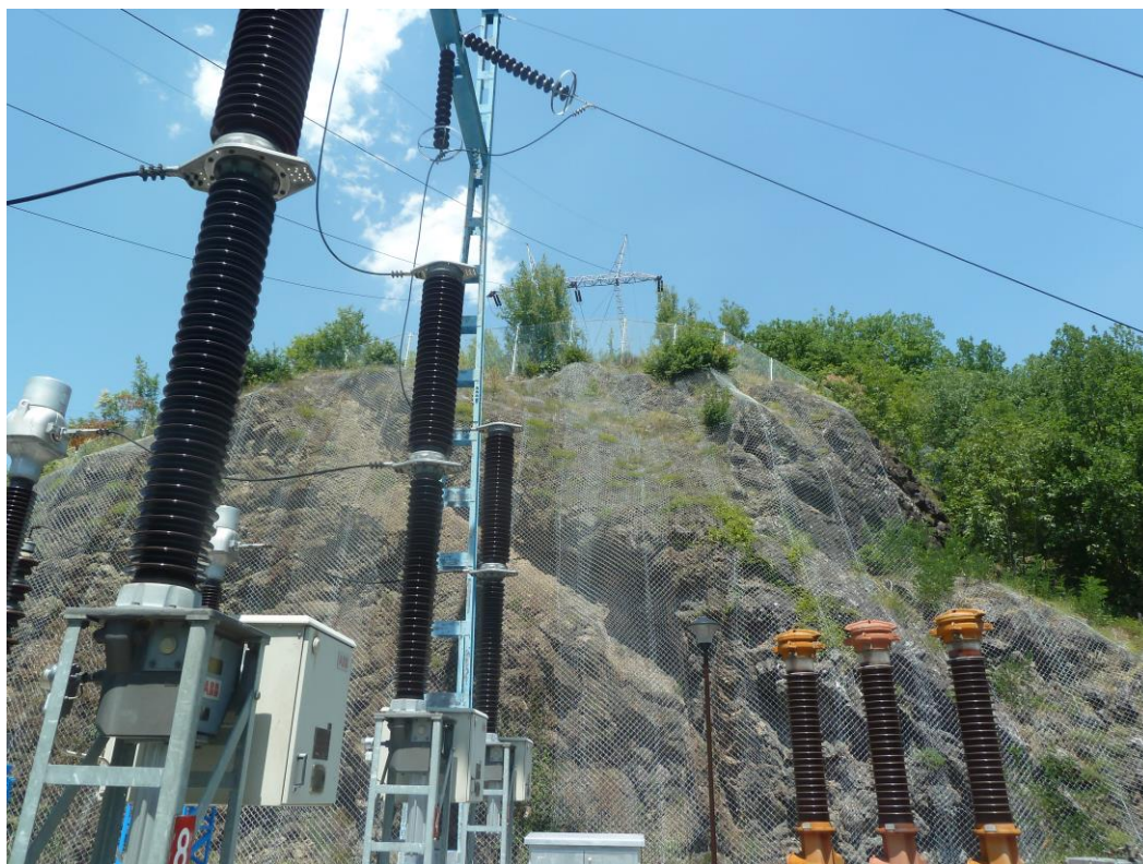
Slika 10.27: Fotografija dalekovoda 220 kV "Bajina Bašta"
