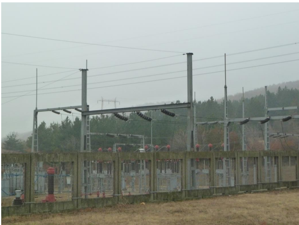
Slika 10.14: Fotografija gromobranskih elemenata (štapnih hvataljki i zaštitne użadi) postrojenja 110 kV HE "Đerdap 1"
