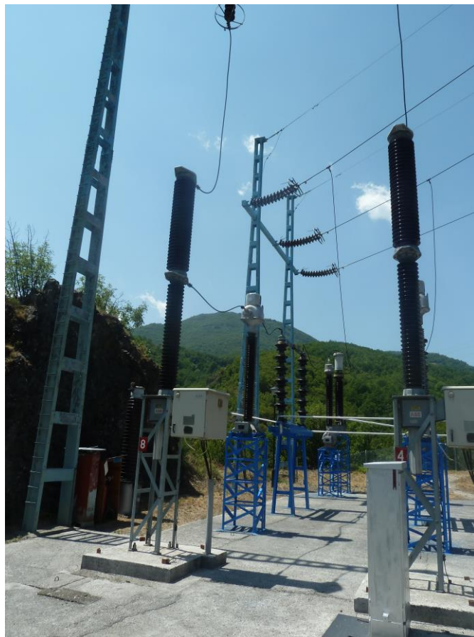
Slika 10.26: Fotografija prihvatnog sistema u vidu dva zaštitna užeta iznad postrojenja 220 kV HE "Bistrica"
