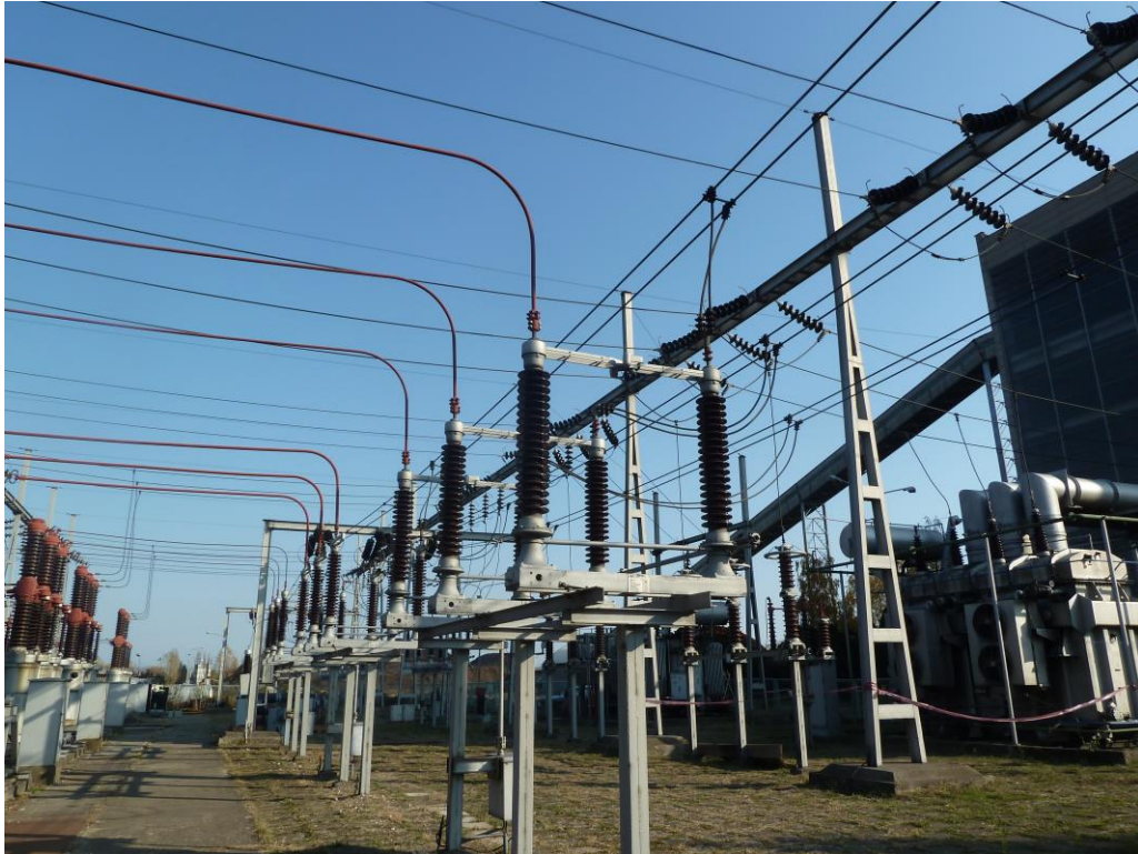
Slika 10.18: Fotografija visokonaponskih elemenata postrojenja 110 kV TE "Morava"
