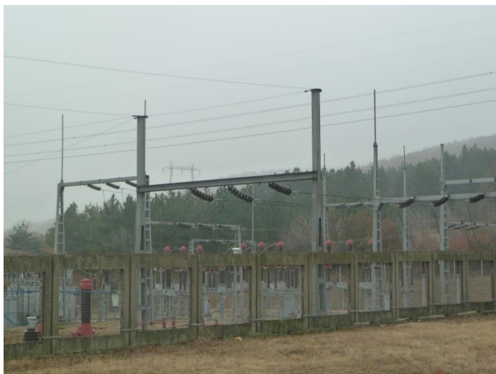
Slika 7.3: Postrojenje 110kV HE "Đerdap 1"
