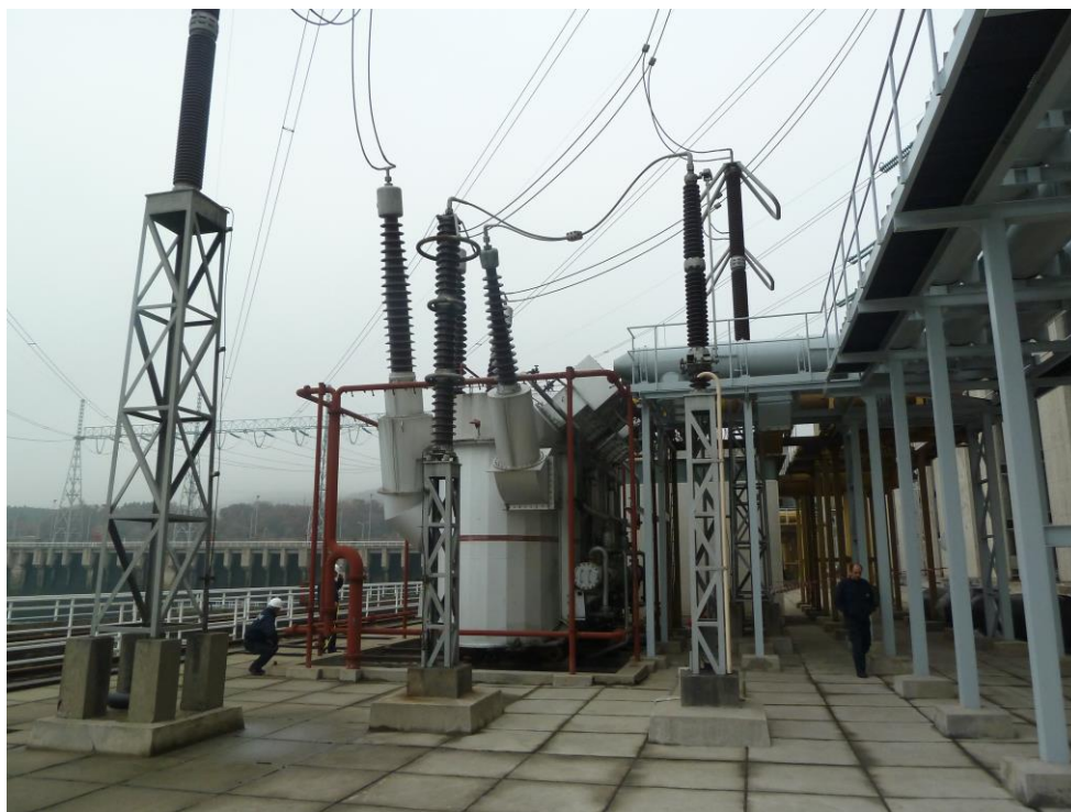
Slika 10.4: Fotografija blok transformatora T1
