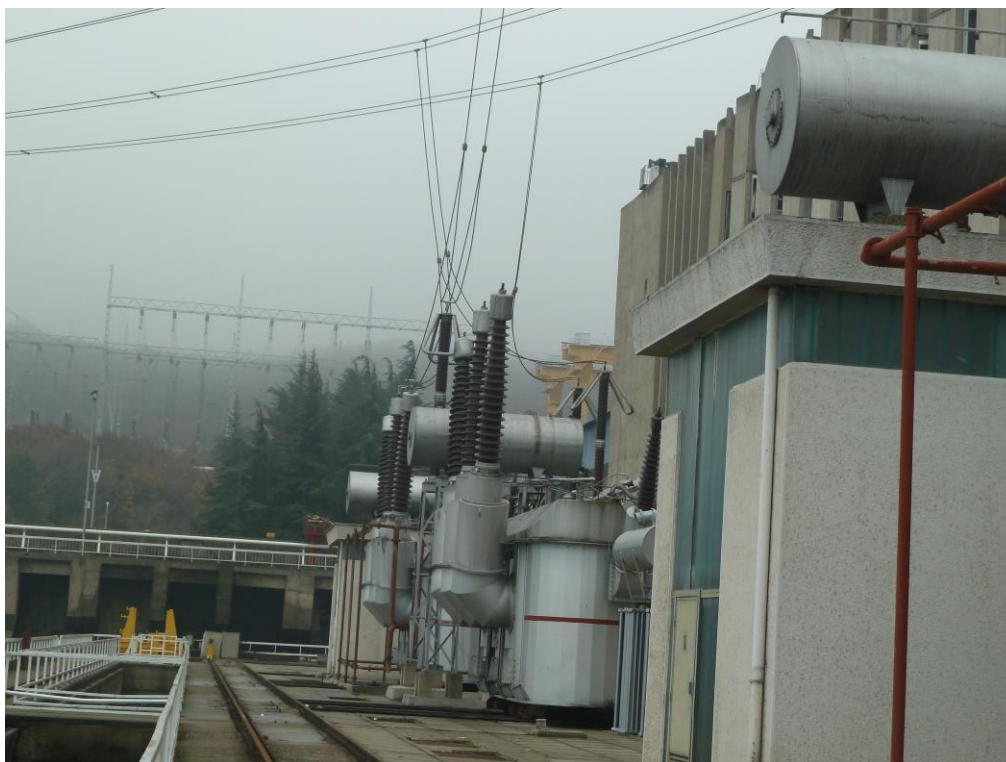
Slika 10.6: Fotografija blok transformatora T2 i T3 HE "Đerdap 1"
