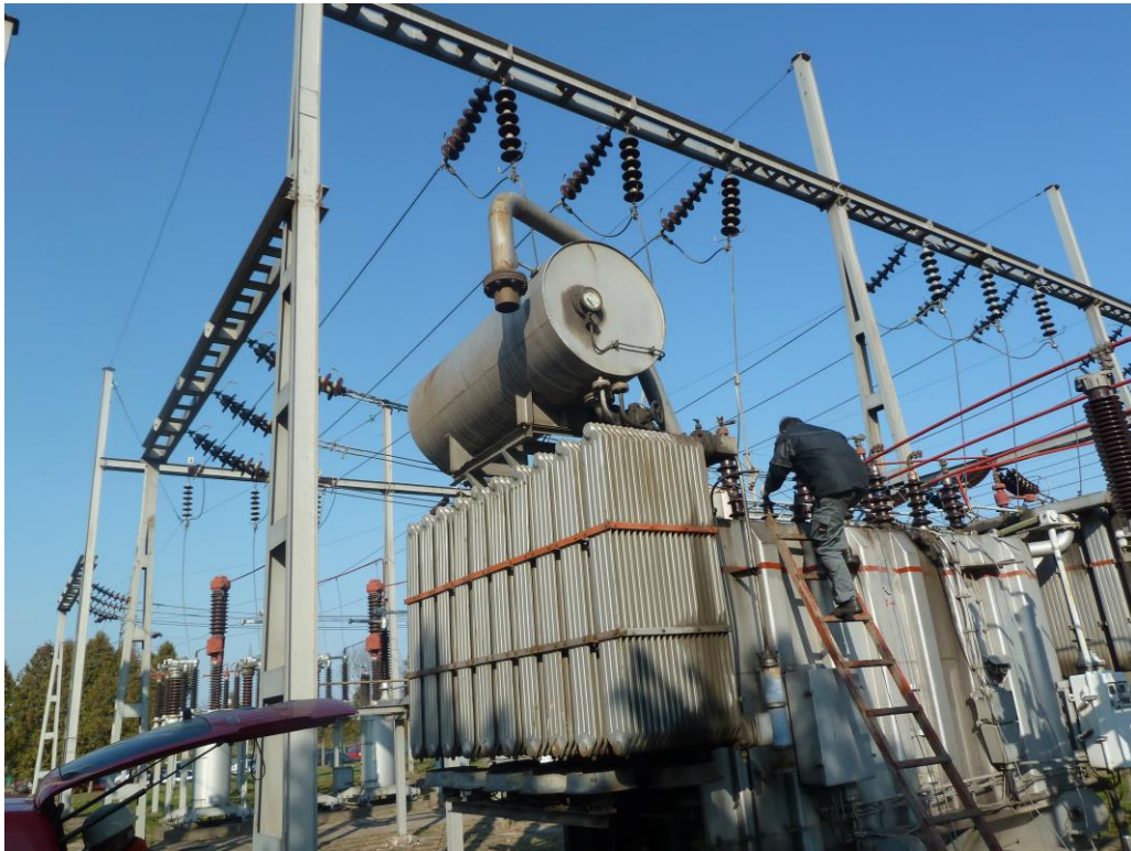
Slika 10.16: Fotografija transformatora T_1 u sklopu postrojenja 110 kV TE "Morava"
