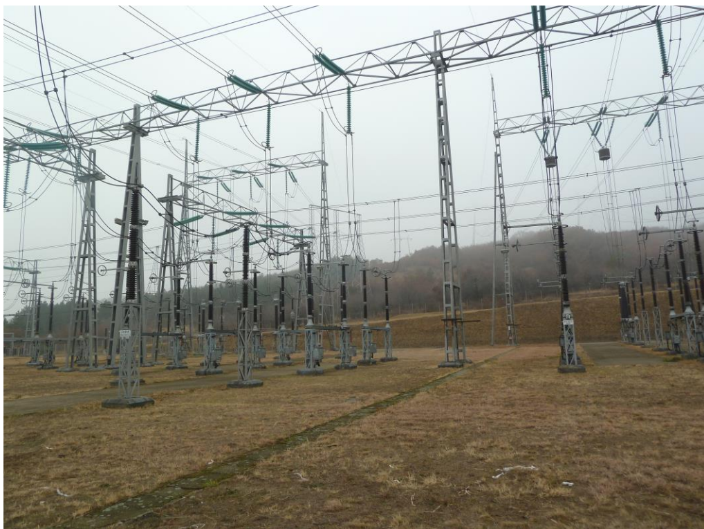
Slika 10.13: Fotografija dela postrojenja 400 kV HE "Đerdap 1"
