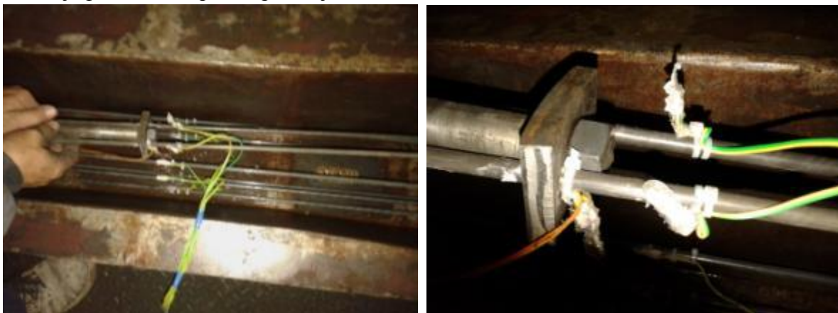
Slika 154. Pucanje zavrtnja i oštećenje pojedinih mernih traka
