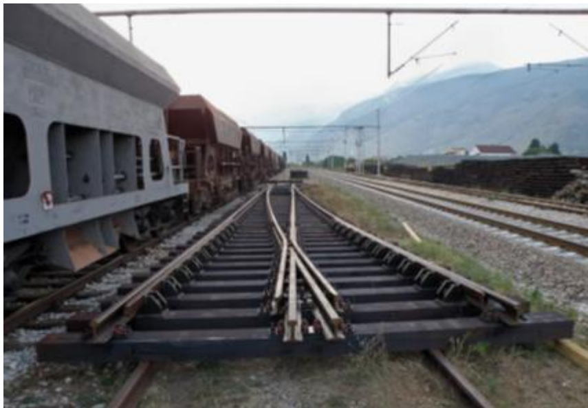
Slika 9. Drveni pragovi u skretnici [34]
