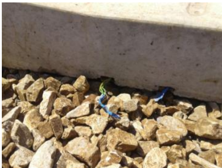
Slika 156. Izvodi mernih traka, prag B70, L=240cm, montiran u kolosek u blizini betonjerke u Stalaću
