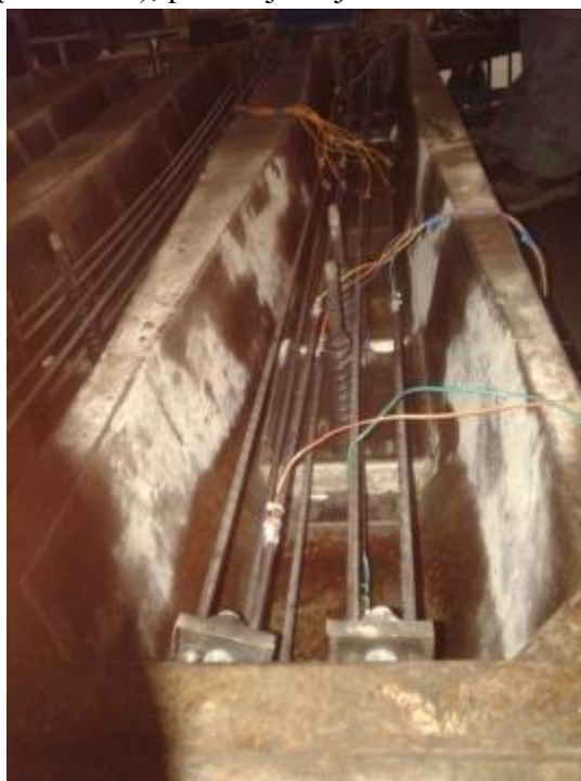
Slika 109. Montaža žica za prednapreznje sa mernim trakama u kalup prednapregnutog betonskog praga B70, l=260cm
