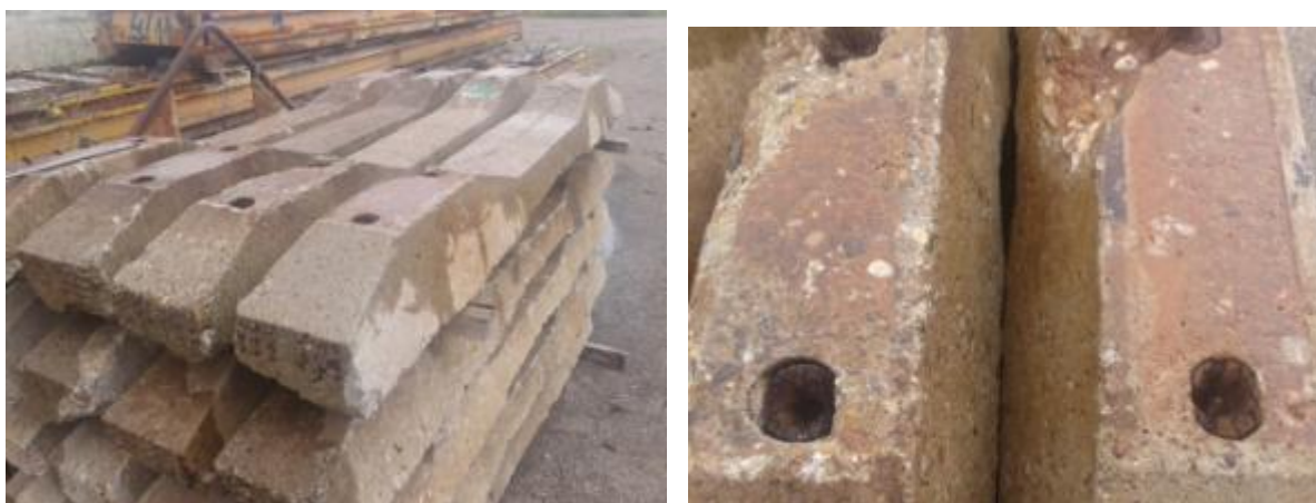
Slika 10. Betonski železnički prag sa drvenim čepovima na reparaciji u Betonjerci u Stalaću
