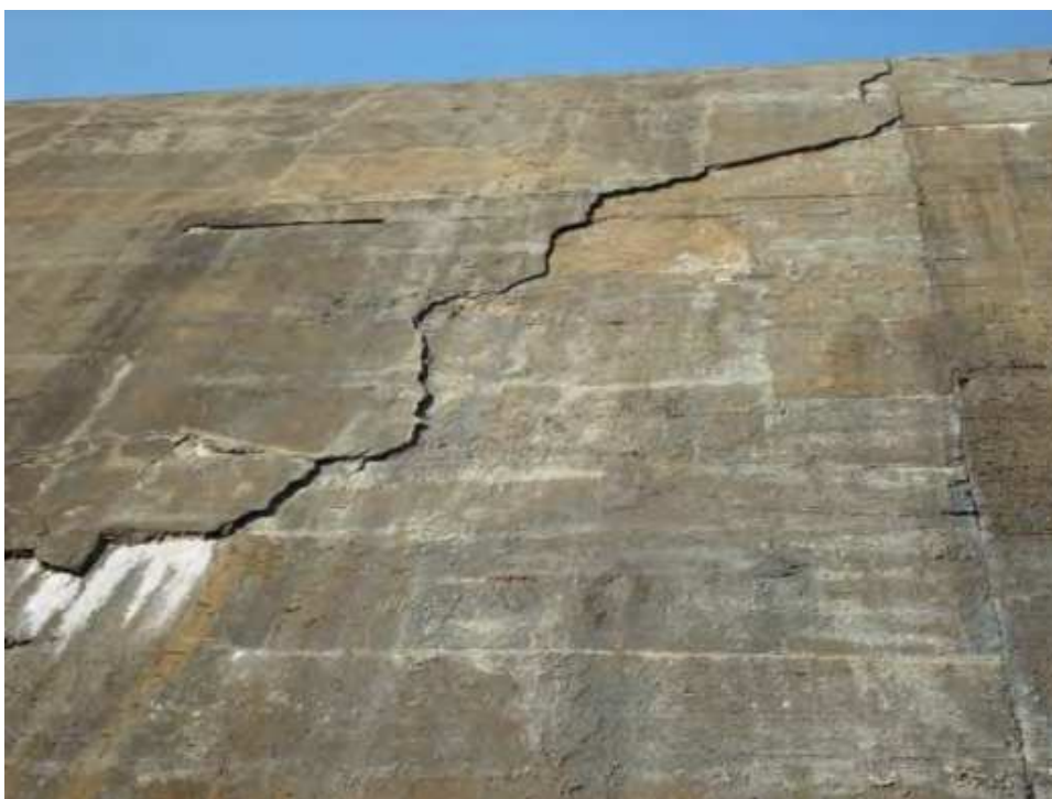
Slika 8.2.10. Pogled na prelivnu branu (slika gore) i detalj deterioracije betona prouzrokovanog hidro-abrazivnim procesom (slika dole) [253]
