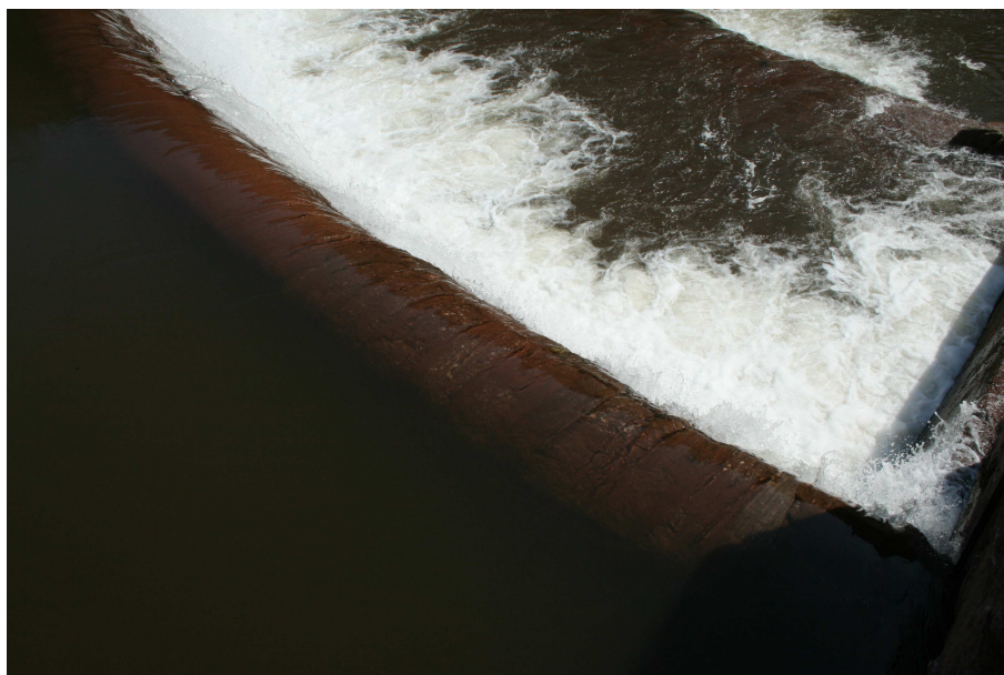
Slika 8.2.3. Oštećena prelivna ivica brane na zahvatu HE „Temac“
