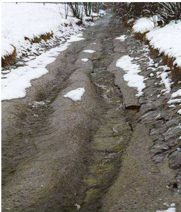
Slika 8.2.1. Oštećenje rečnog korita od betona usled hidro-abrazivnog habanja [29]
