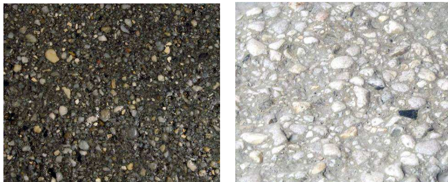
Slika 2.4. Površine izložene hidro-abraziji sa vidljivim habajućim oštećenjem levo/desno: prečnik zrna manji ili jednak od 8/16mm [23]
