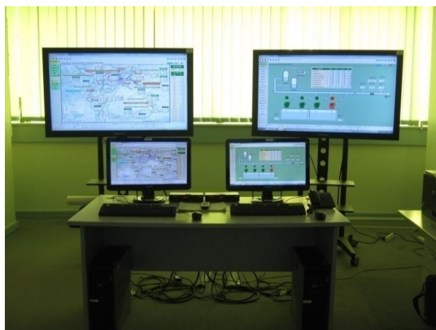
Slika 5.3 Glavna kontrolna soba
