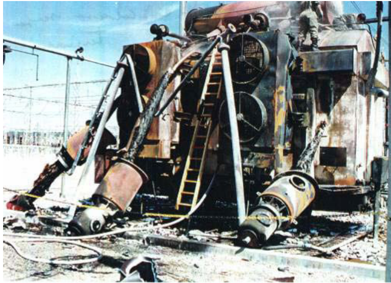
Слика 1.2.1. Последице кратког споја Short – Circuit withstand capability Copyright 2012 ABB CUSTOMER CONFIDENTIAL. Електронски извор [19].
