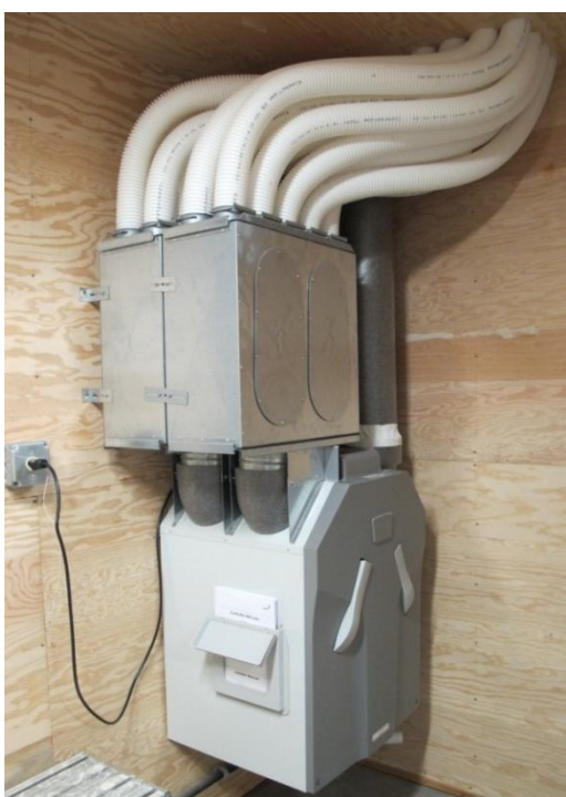
Slika 15. Ventilacija u pasivnoj kući proizvođača “Zehnder”
