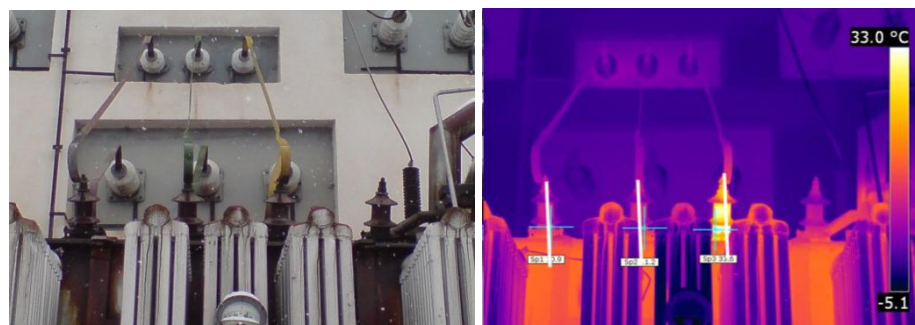
Slika 5.43. Fotografiska i termografska slika provodnih izolatora transformatora na 10 kV strani [72]
