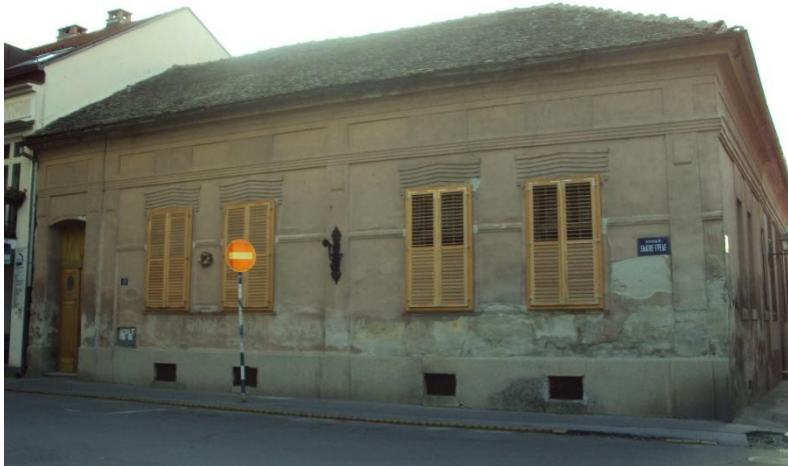
Сл. 376: Кућа на углу улица Златне греде и Милована Видаковића у Новом Саду, прве деценије 20. века. Извор: аутор рада
