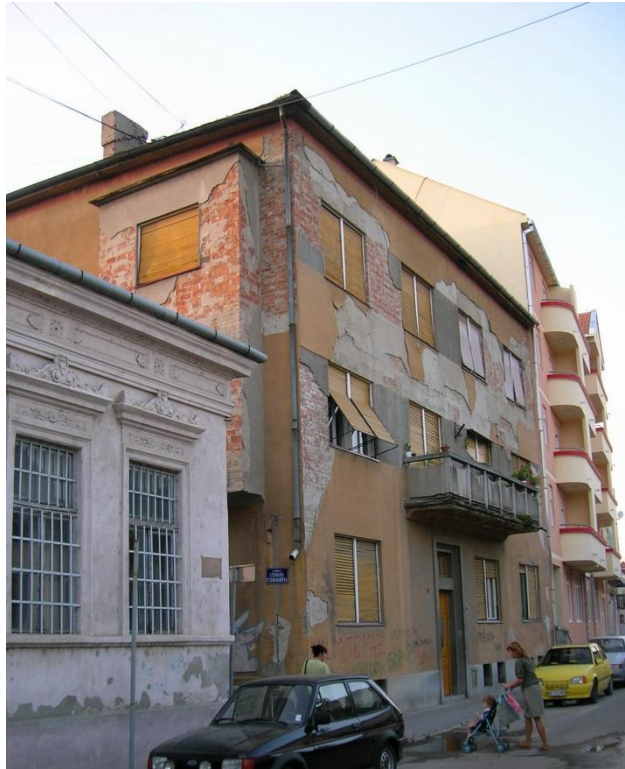
Сл. 766: Ђорђа Табаковића, Зграда у Арсе Теодоровића 13 у Новом Саду, 1939. Извор: аутор рада
