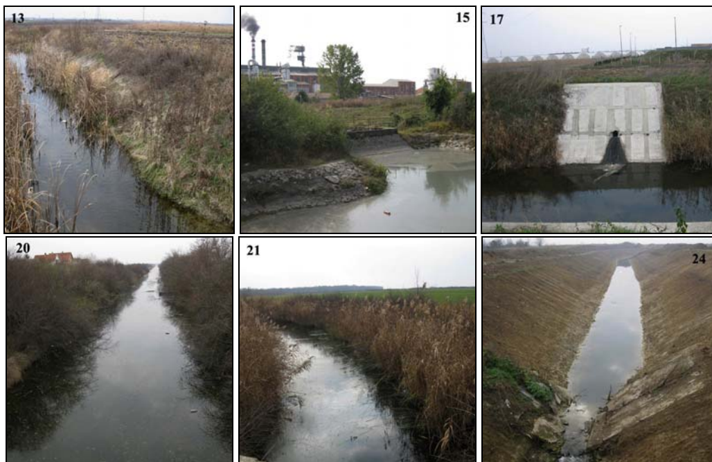
Slika 9. Kanal "Galovica" sa bočnim kanalima koji se u njega ulivaju
