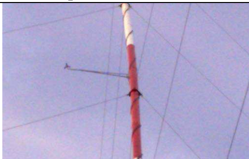
Slika 3: Oprema na visini 40 m
