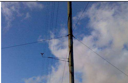
Slika 4: Oprema na visini 10 m
