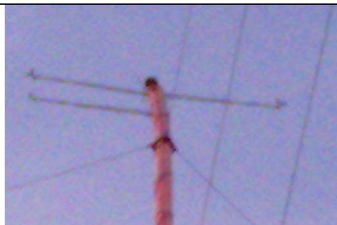
Slika 1: Oprema na visini 58,5 - 60 m
