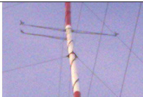
Slika 2: Oprema na visini 48,5 - 50 m
