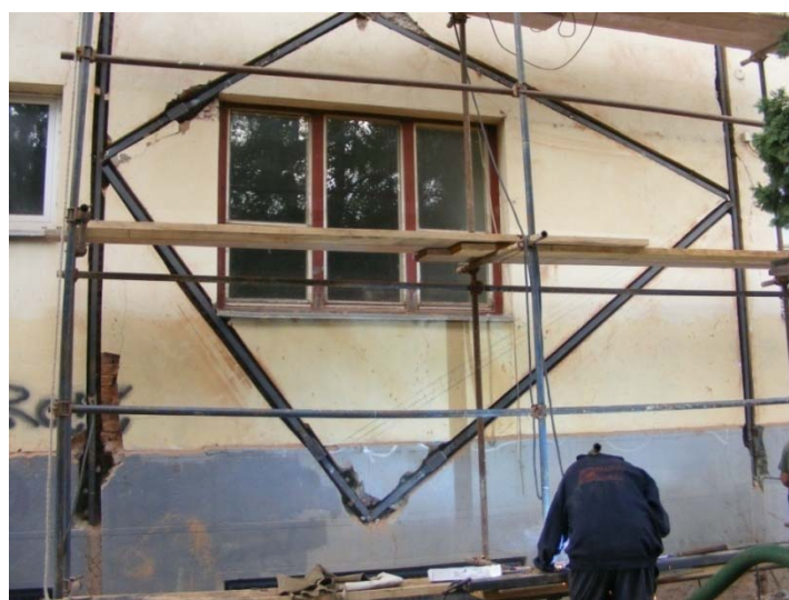
Сл. 120 Укрућења спремна за заливање ситнозрним бетоном од челичних елемената дим. 50x80 мм.
