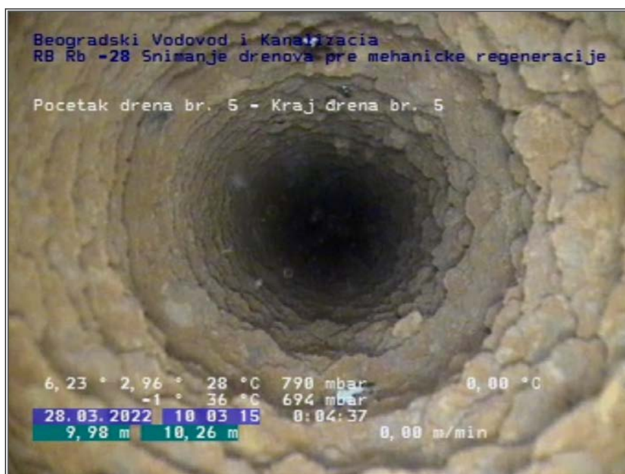
Slika 41: Detalj snimaka podvodnom kamerom unutrašnjosti PVC filterskih cevi ugrađenih u drenu broj 5 bunara RB-28 (ugrađenih pet godina pre snimanja izvršenog uoči regeneracije tokom marta i aprila 2022.)
