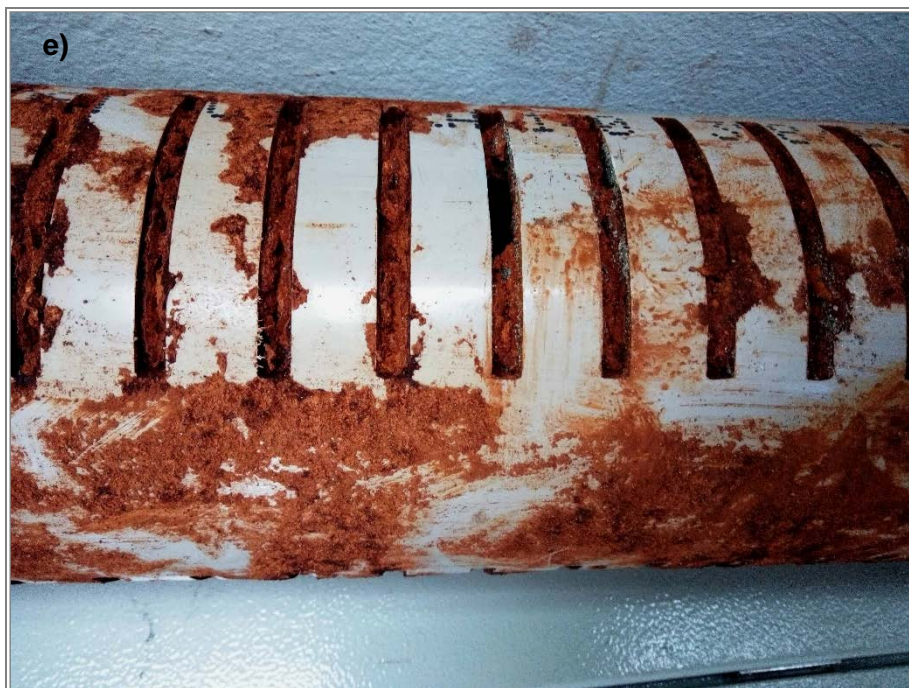
Slika 42: Izgled izvađene PVC filterske cevi; detalj a) i b): debljina kolmiranog sloja u unutrašnjosti cevi; detalj c), d) i e): krupne perforacije na filterskoj cevi intenzivno zapunjene produktima kolmiranja gvoždem
