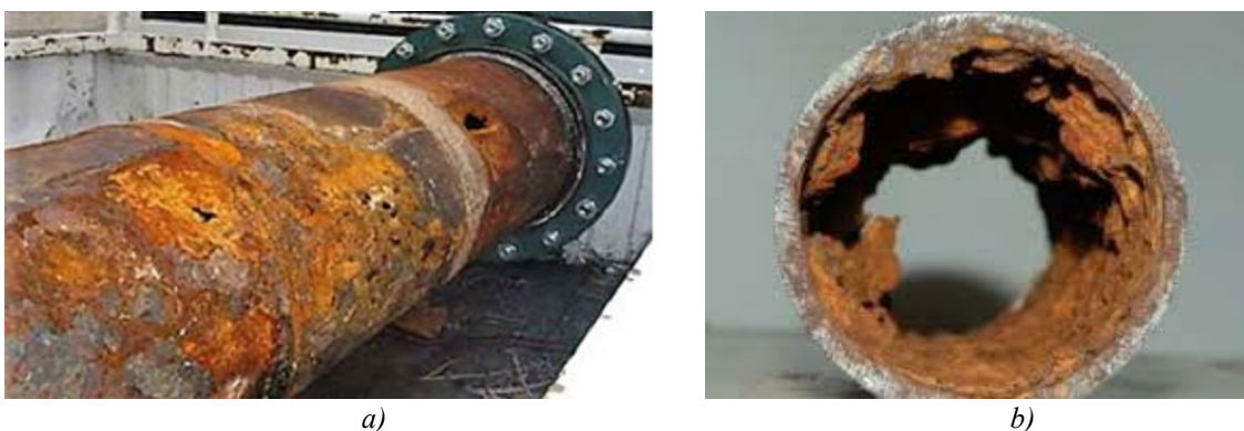
Slika 6.2. Korozija metala na cevovodu a) korozija spolja i b) korozija unutar cevovoda
