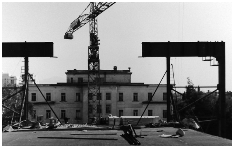
Слика 124 – Реконструкција старе зграде ЦНП-а (1990 – 97). Постављање челичних носача због неопходног проширења објекта у попречном правцу, по пројекту арх. Радмиле Николић и инг. Добрила Николића. (Извор: инг. Добрило Николић, „Биро СТ – Сценска техника“, Београд)
