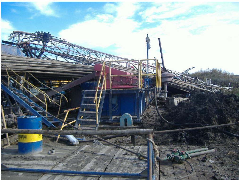
Slika 10.5. Srušeno remonto postrojenje.
