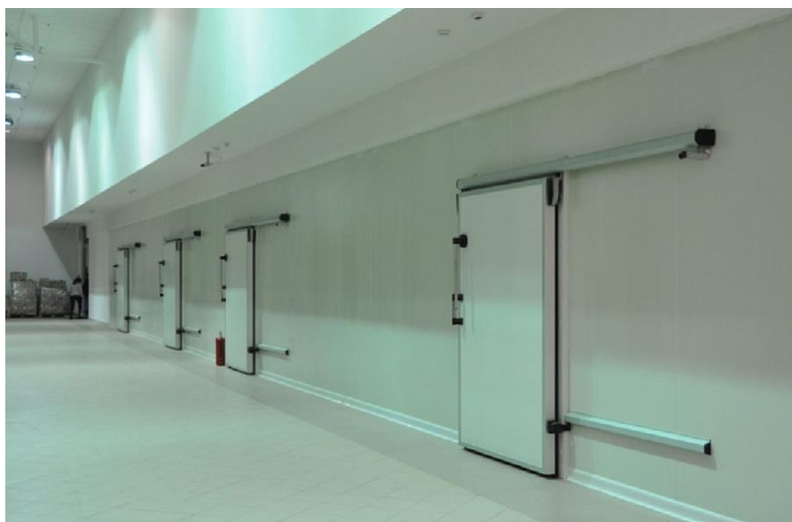
Slika 5.4. Tuneli za zamrzavanje
