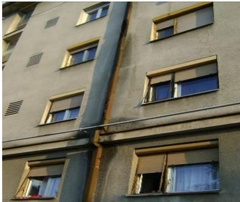
Slika 3.3.: Curenje oluka na stambenom objektu u Novom Sadu
