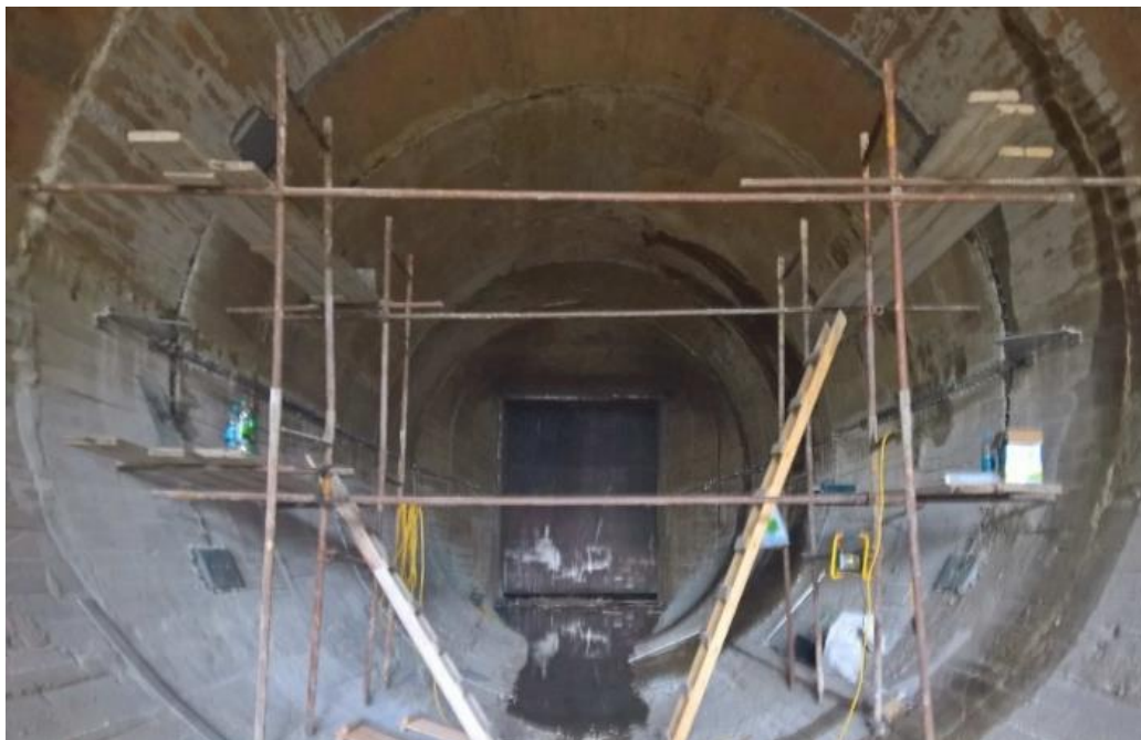
Slika 6.13 Detalji izvedenog mernog mesta Pađeni u neposrednoj blizini ulazne građevine tunela FP – BA u Fatničkom polju: Levo) Podsystem Large Flat DC-2 EM senzor (EM-B1 i EM-B2) i EM senzor brzine u toku „Ajkulino Krilo“ (EM kontrolna – B), Desno) Merno mesto tokom montaže.
