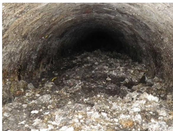
Slika 2.12 Kanalizacioni kolektor blokiran očvršćenim masnim naslagama u Londonu, Ujedinjeno Kraljevstvo (preuzeto sa www.neogaf.com )
