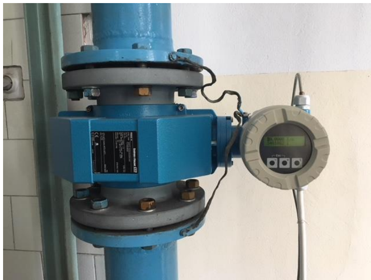
Slika 2.1 Endress – Hauser cevni EM senzor protoka na instalaciji u hidrauličkoj laboratoriji Građevinskog fakulteta, Univerziteta u Beogradu.
