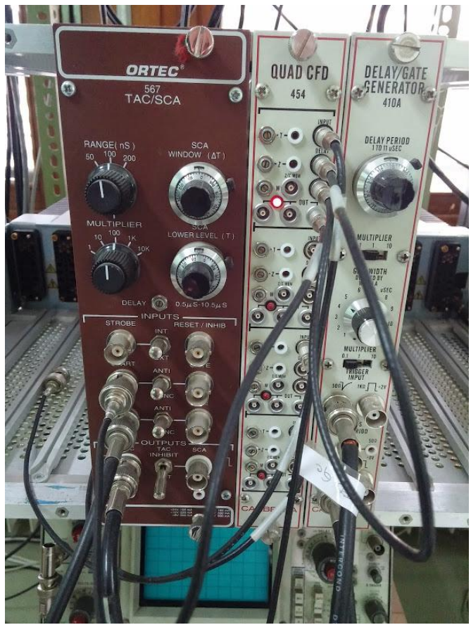
Slika 52 Izgled modula: TAC, QUAD CFD i D/G GENERATOR
