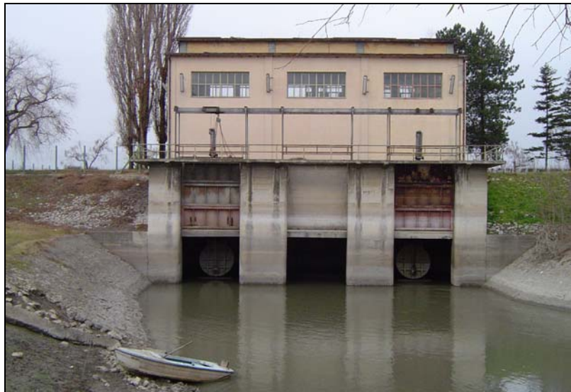
Slika 28. Crpna stanica Žabalj neposredno pre ušća Jegričke u Tisu (km 37) (foto: D. Pavić, 2005)
