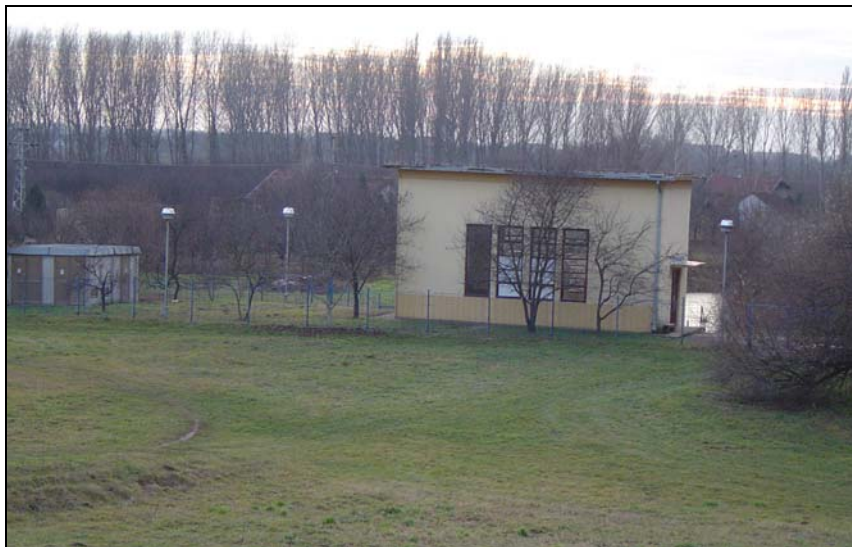
Slika 22. Crpna stanica Martonoš na desnoj obali Tise na km 157 (foto: D. Pavić, 2005)
