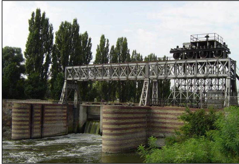
Slika 27. Ustava Bečej na ušću kanala Bečej - Bogojevo u Tisu (km 73) (foto: D. Pavić, 2004)
