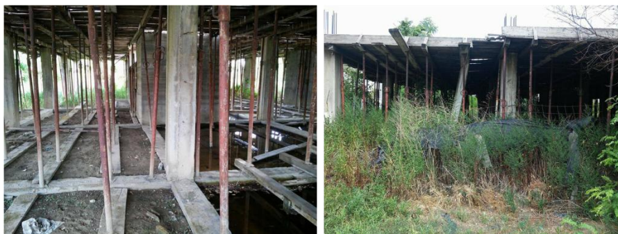
Akumulacija vode u neizgrađenom objektu (Izvor: Kavran M., 2017 Novi Sad)
