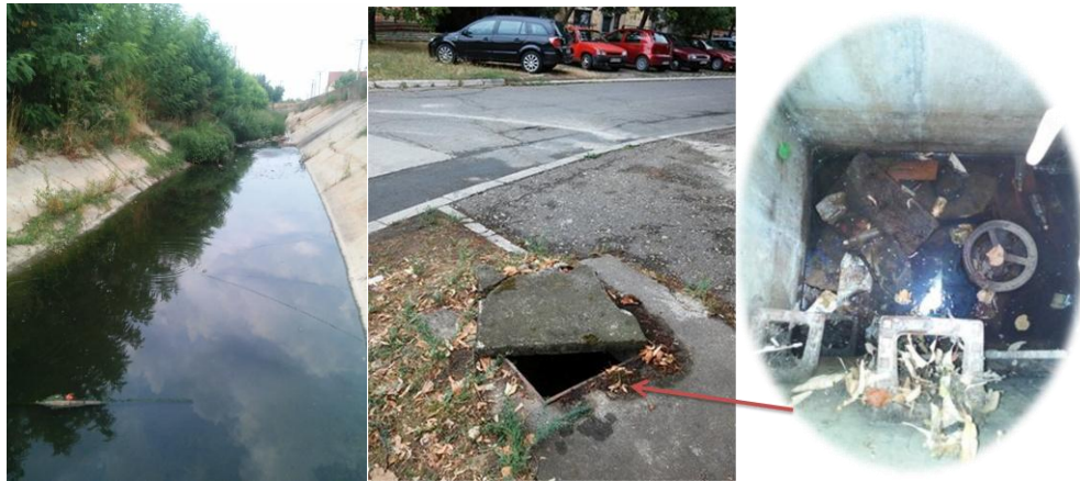
Rokov potok- kanalisani deo toka (levo) i šaht u urbanoj sredini (sredina i desno) (Izvor: Kavran M., 2016 Petrovaradin; 2017 Novi Sad)
