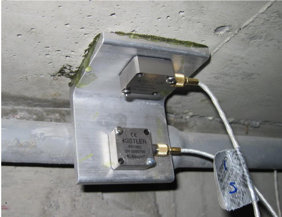
Slika 29: Akcelerometri instalirani na betonskoj konstrukciji mosta
