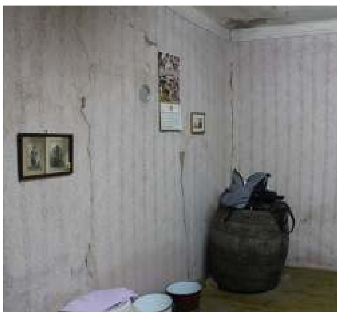
Слика 9.2: Пукотине на зиду од набоја у ентеријеру куће
