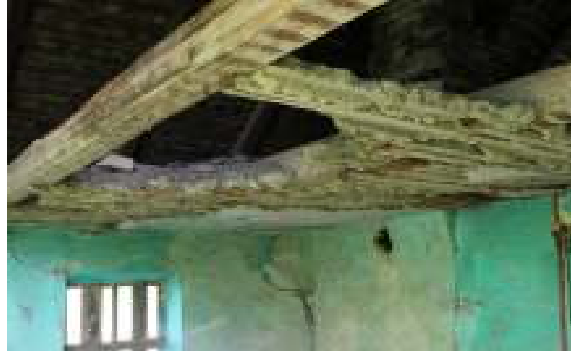
Слика 3.35: Остаци међуспратне конструкције у напуштеној војвођанској кући
