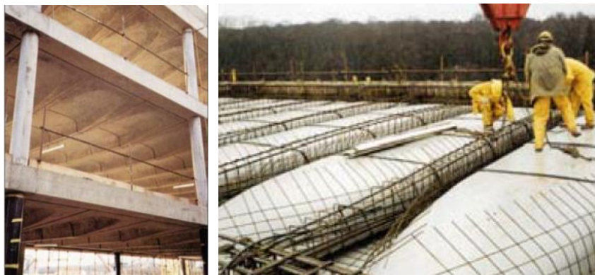
Слика 7. Армиранобетонска међуспратна таваница током изградње пословне зграде компаније PowerGen; Ковентри, УК, 1994., архитектонско решење Бенетс и сарадници. [Извор: В.Т. О'Неилл, Г. Шау и М. Флинн, Project Profile: PowerGen Headquarters (British Cement Association, 1996), 7]
