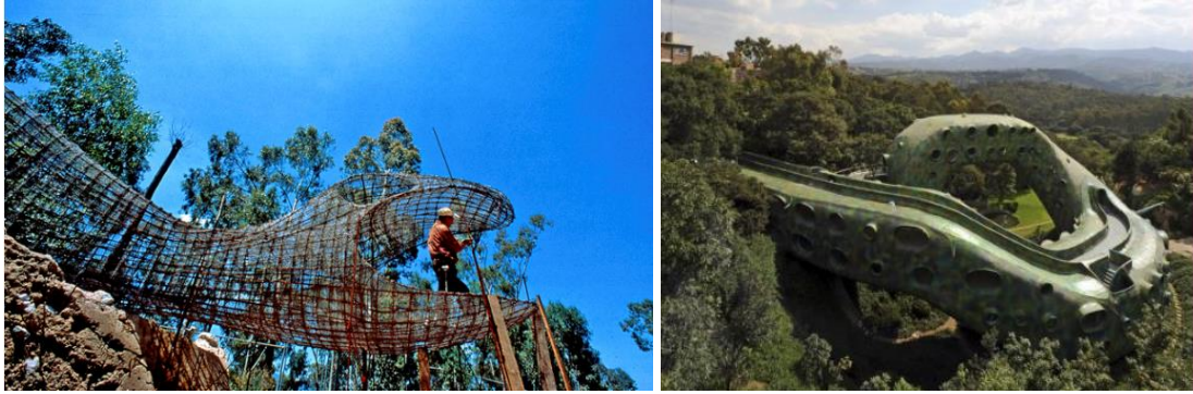
Слика 110. Хавиер Сеносиан, Кецалкоатлово гнездо, Мексико, 2007., изградња, фасада, ентеријер. [Преузето са http://www.arquitecturaorganica.com/nido-de-quetzalcoatl.html , 24.8.2012.]
