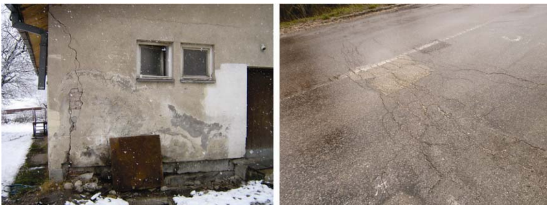
Slika 114. Deformacije na objektima i saobraćajnicama izazovane sleganjem terena u području zapadnog polja rudnika „Soko“ (foto S.Kokerić) slika levo: zgrada rudnika; slika desno: lokalni put Soko Banja-Čitluk
