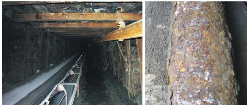
Slika 217. Izgled korodirane metalne podgrade u rudnicima uglja (foto: slika levo časopis „Rudar“ -Resavica, slika desno B.Miladinović)
