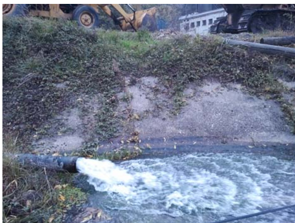
Slika 283. Mesto ispumpavanja rudničkih voda iz jame rudnika „Soko“ (foto B.Miladinović)
