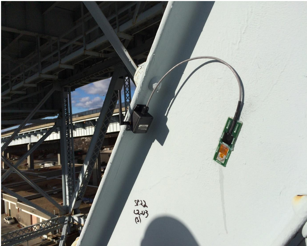
Slika 6.24. Wireless merna traka postavljena na metalnu konstrukciju mosta [190].
