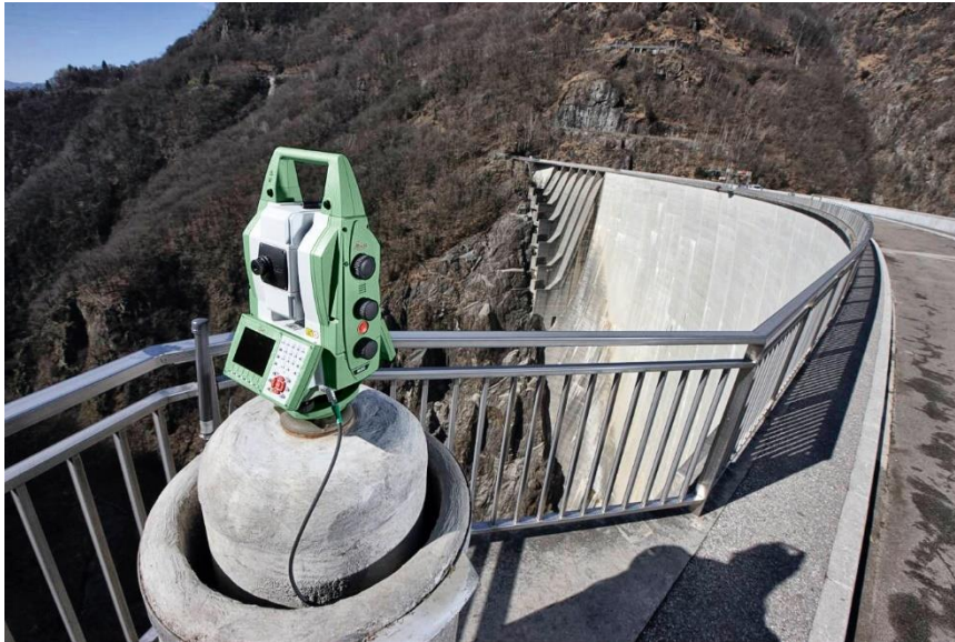
Slika 6.2. Robotizovana totalna stanica stabilizovana za potrebe monitoringa brane [89].
