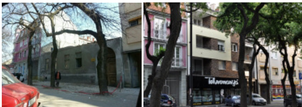
Slika 266. i Slika 267. Rušenje starog jednorodnog objekta (slika levo) u centralnom gradskom jezgru Sombora i izgradnja novog stambeno poslovnog objekta (slika desno)
