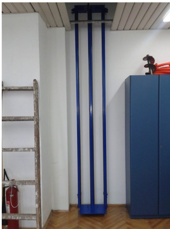
Слика 46. Конструкција лифта причвршћена на зид: вођице, горња и доња монтажна плоча.
