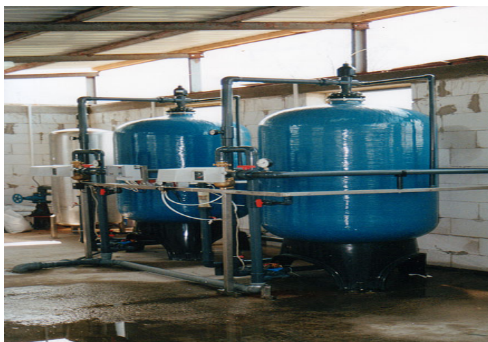
Slika 44. Kolone za demanganizaciju instalirane na izvorištu u Kriškovcima
