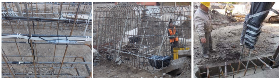
slika 5.2 – sonde za merenje deformacija armature temelja
