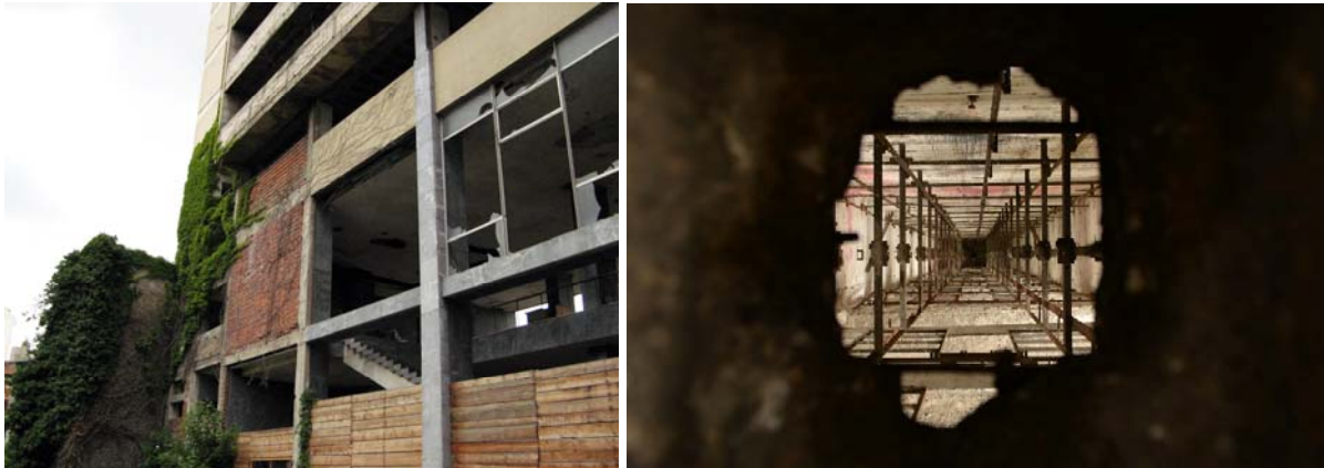
Dvorišna fasada, zarasla u bršljenu (levo) i pogled kroz okno lifta (desno).
