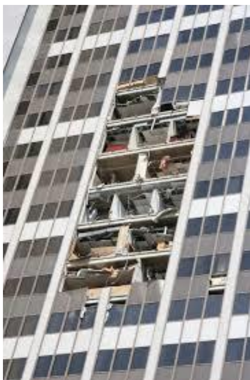
Slika 4.17. Oštećenje fasadnog zida (Kazmierczak 2010)
