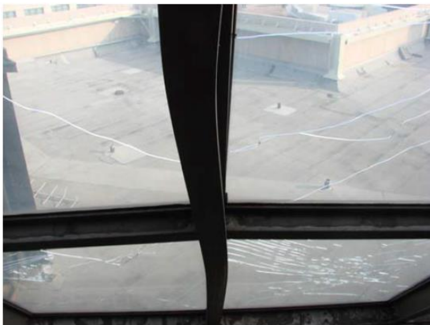
Slika 4.16. Laminirano staklo (laminated glass) izloženo dejstvu jakog vetra ostaje u ramu ali dolazi do deformacije vertikalna i horizontalna
