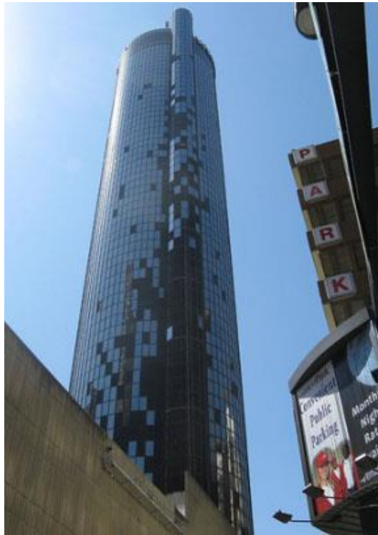
Slika 4.9. Oštećena fasada tipa zid zavese tokom tornada, Atlanta 2000 (Beers 2011) https://buildingenvelope.files.wordpress.com/2011/05/tornado.jpg
