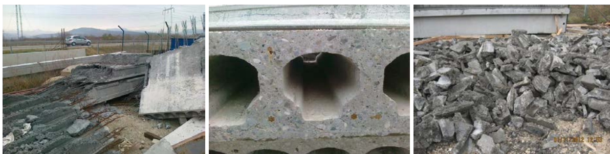
Слика 4.5 Механички оштећене ошупљене плоче
