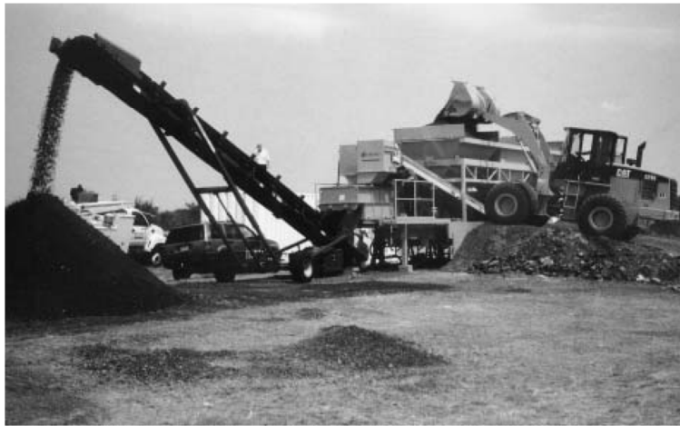
Slika 13 Centralno postrojenje za hladno recikliranje. [16]
