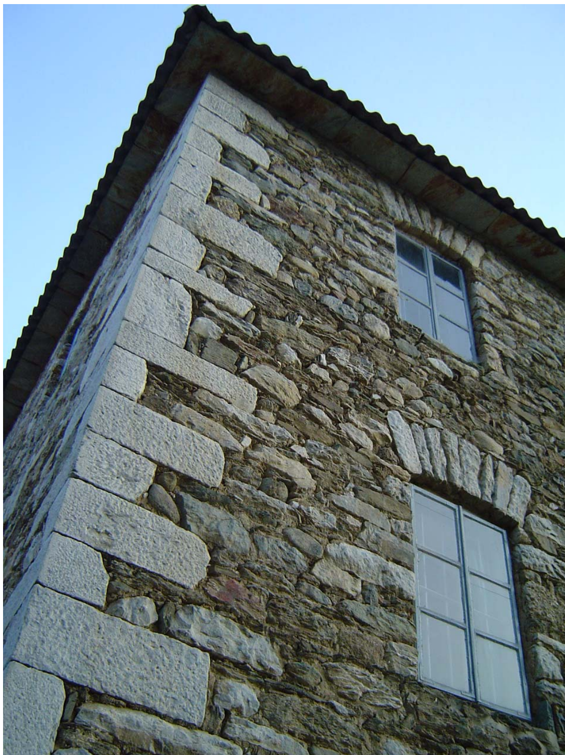
Слика 28. Мушничово, кућа Недељковића - детаљ ћошка
