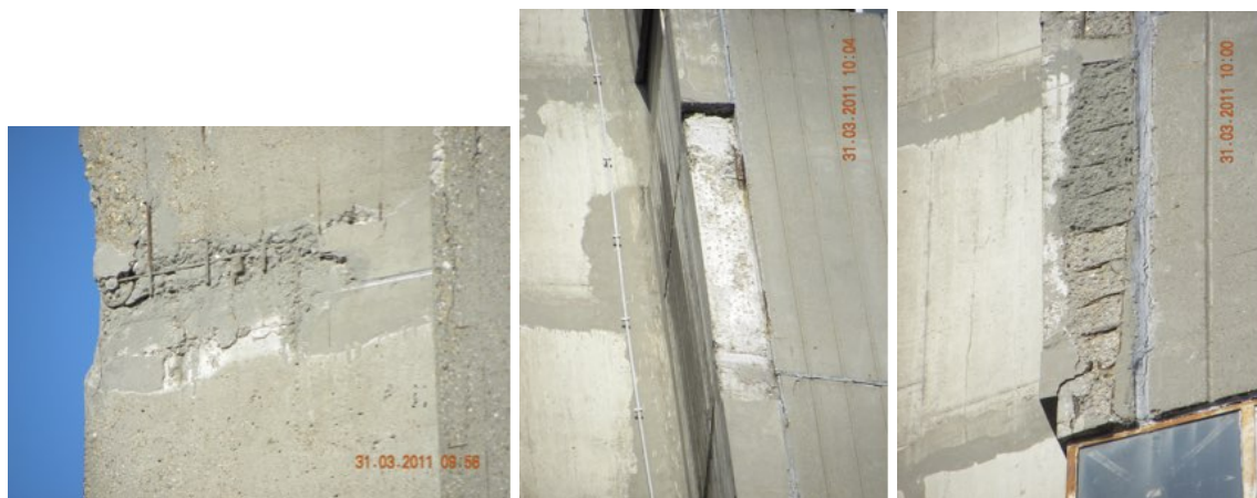
Слика 3-9 Оштећени фасадни панели на зградама Рудо 1-3 | Фотодокументација Грађевинског факултета Универзитета у Београду
