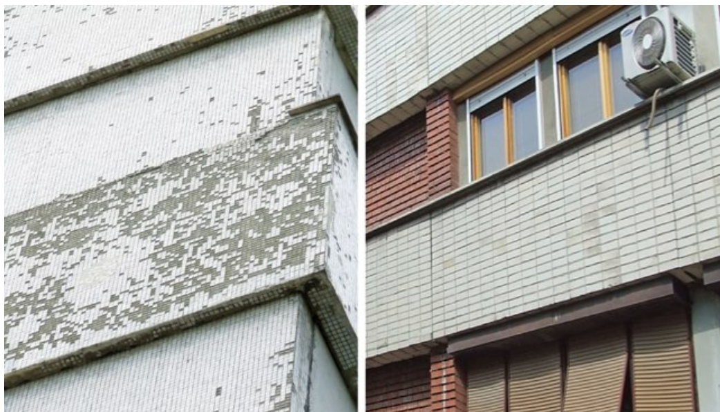
Слика 3-11. Фасадна облога од керамичких елемената у релативно добром стању (десно) и са већим оштећењима (лево)
