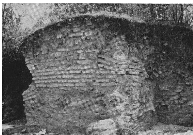
Слика 28: Потпорни лукови степеништа источног бедема Доњег града, поред северне куле источне капије, поглед са југозапада.
