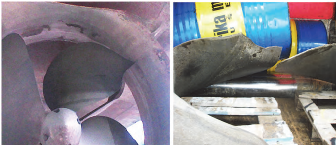
Слика 7.18 – Оштећења пропелера која су уочена приликом ремонта брода 97 који је обављен 2011. године
